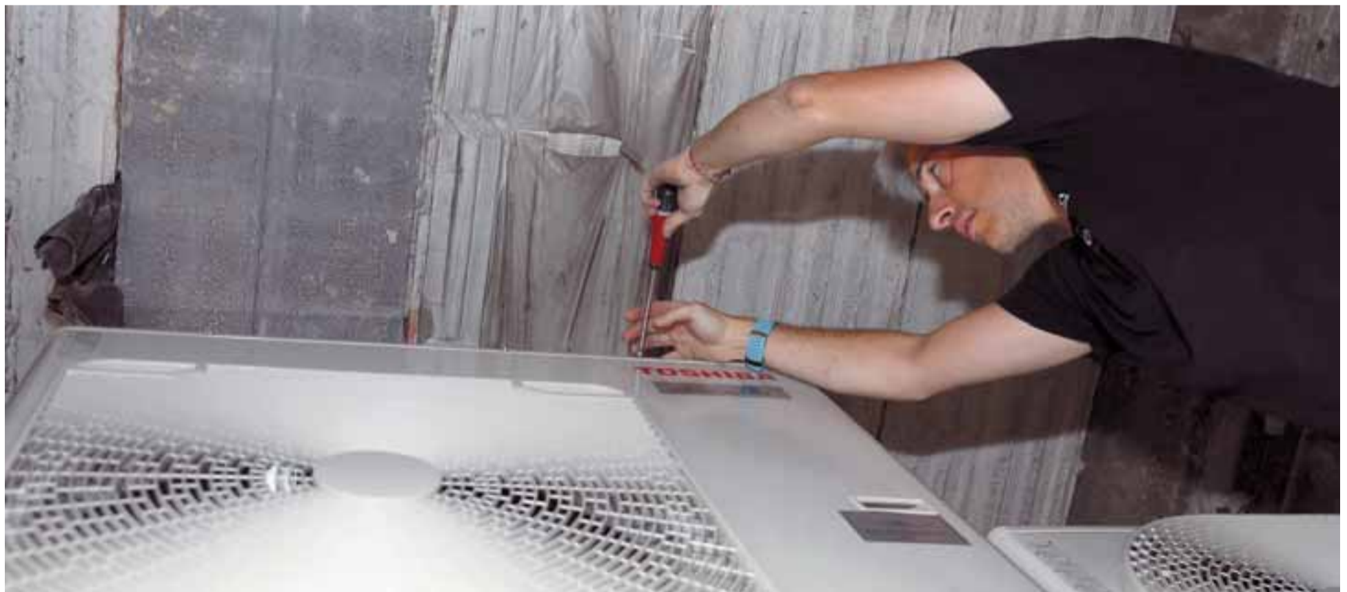
Un trabajador de Galván Frío Industrial instala un dispositivo de refrigeración en un establecimiento de la calle Amaya de Pamplona.
